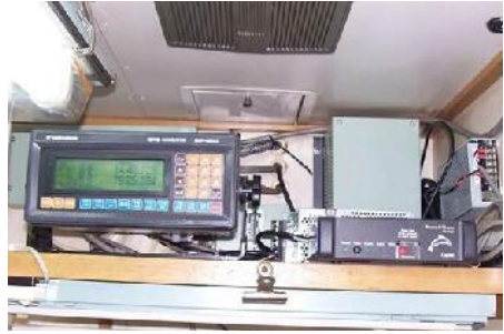
Figure 64: Deux unités de SSN installées à bord d'un palangrier thonier (Thrane & Thrane 3022D INMARSAT et boîtier de raccordement de l'unité Argos MARGE)
