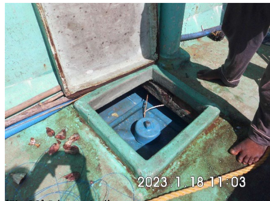
[Fig.30] Réservoir d'eau
